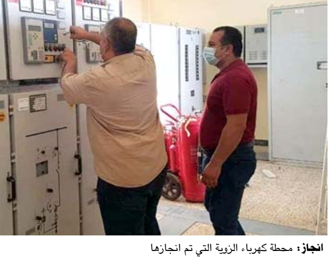
انجاز محطة كهرباء الزوية التي تم انجازها
