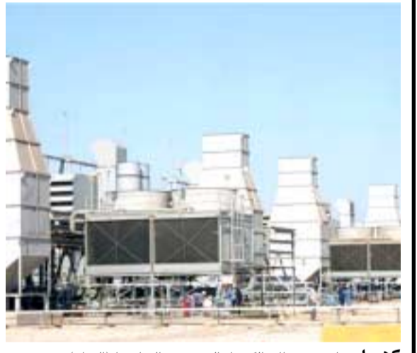
كهرباء : إحدى محطات الكهرباء التي يجري العمل بها (الزمان).
