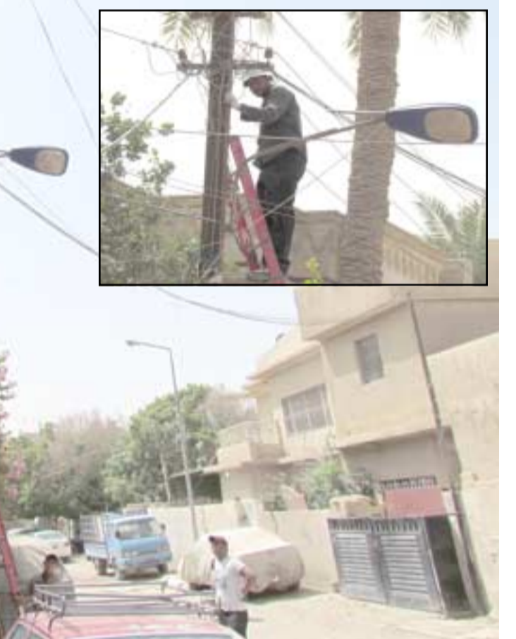
أعمدة : اعمدة انارة الشوارع تشهد اهماً كبيراً حيث اصبحت مرماً لاسلاك المودات ومرتمجا لعشاش الطيور عدسة (الزمان) احمد الحليفي
